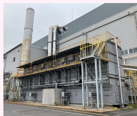
7 蓄熱式燃焼脱臭装置 (RTO)
