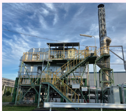
6 蓄熱式燃焼脱臭装置 (RTO)
