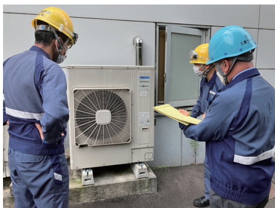
外部審査機関の審査にて室外機のリストを照合する様子
