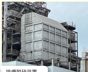
9 排煙脱硝装置
