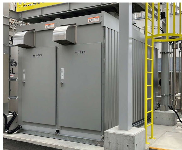
図. 高効率ボイラー
